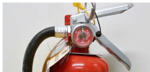
extincteur vérifié et signalé
