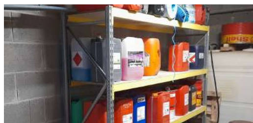
étagères métalliques limitant l'absorption et le risque incendie
